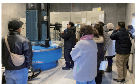
小水力発電所内部の視察の様子
